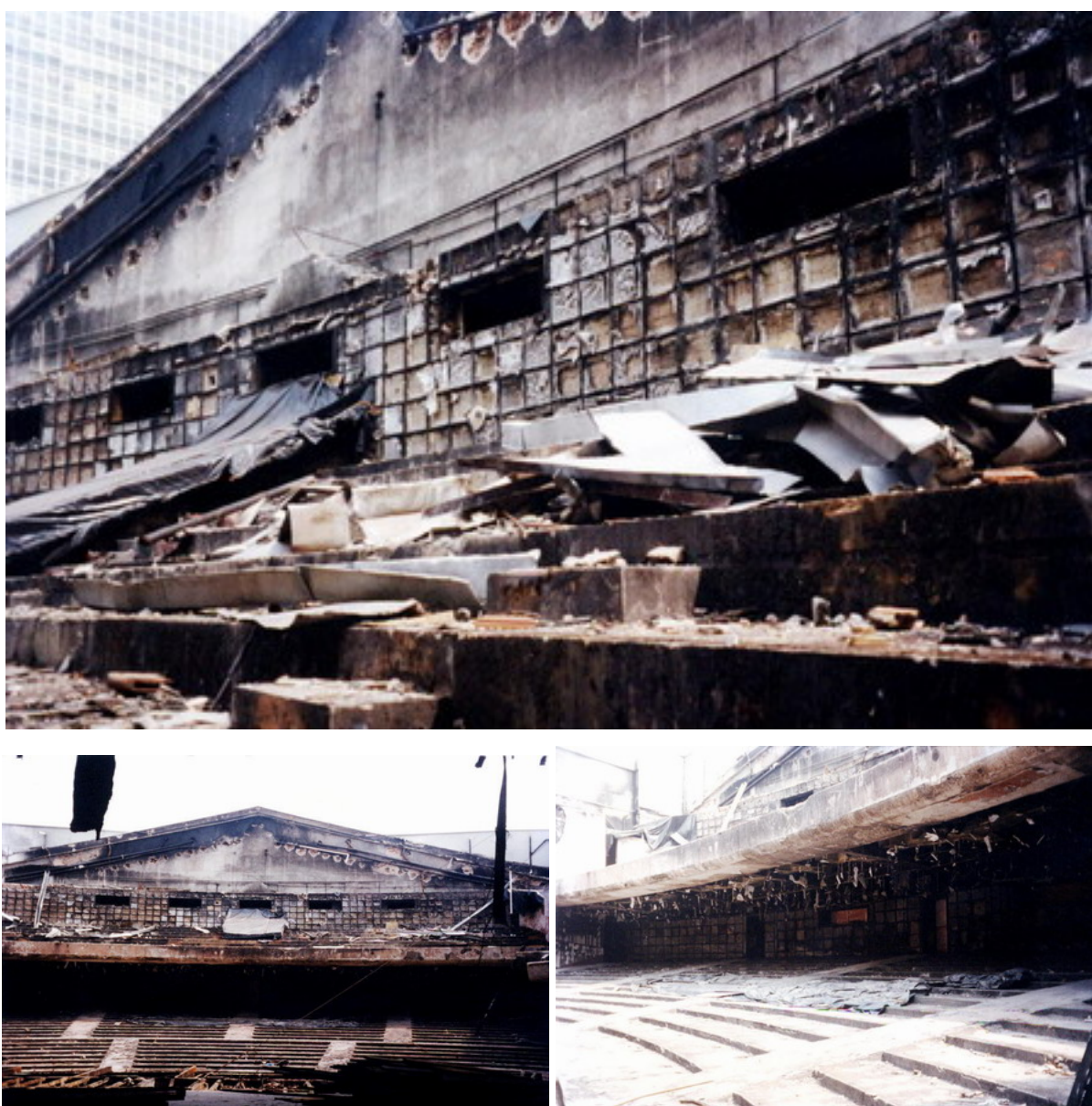
Figura 4-16 – Imagens do Palácio das Artes após incêndio
