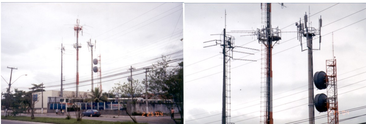
Figura 2.57 Torres de transmissão em Parati.
