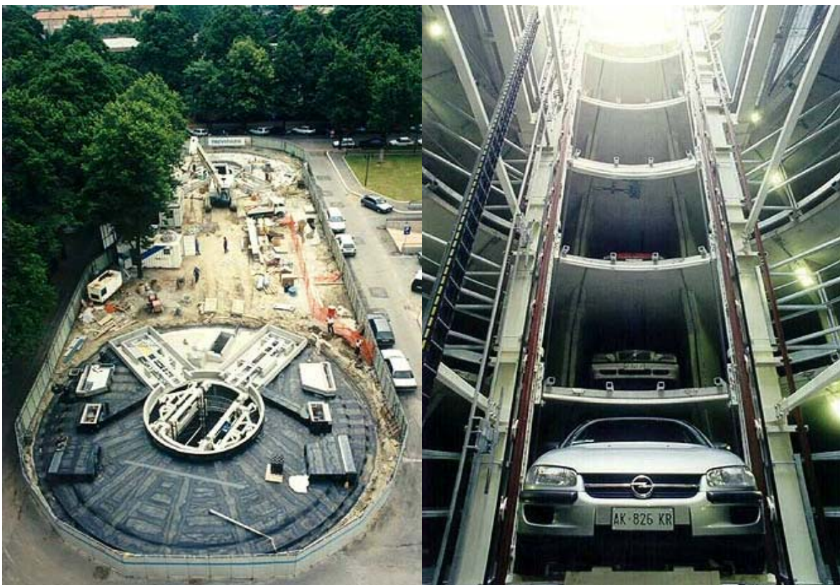
Figura 5.14 - Sistema subterrâneo Trevipark em Cesena - Itália
