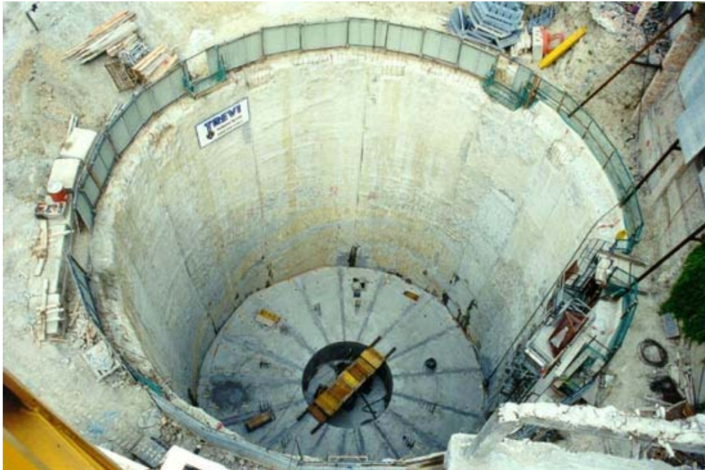
Figura 5.13 - Sistema subterrâneo Trevipark em Cesena - Itália
