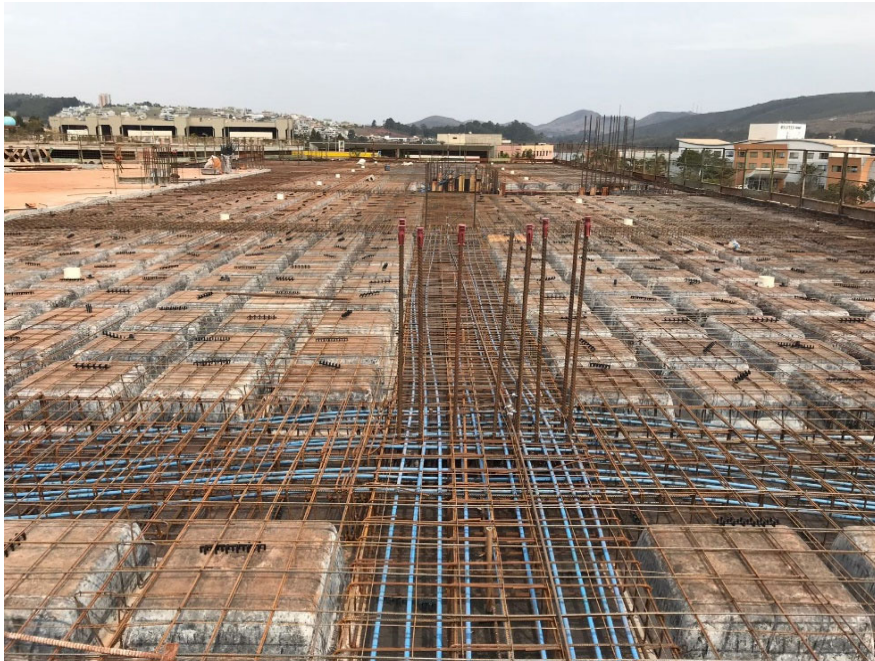
Figura 2.5: Montagem das cordoalhas engraxadas e plastificadas em laje nervurada de edifício comercial (Fonte: próprio autor)
