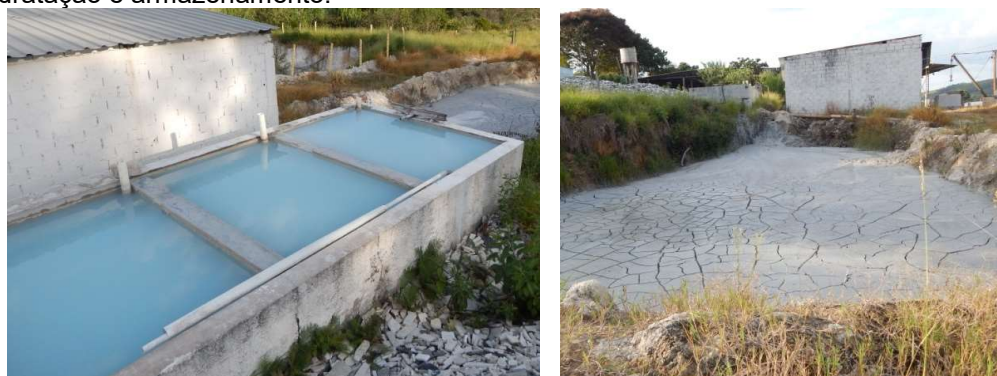
FIGURA 2.5 – Lama de beneficiamento de rochas ornamentais: (a) tanque de decantação e (b) tanque de desidratação e armazenamento.
