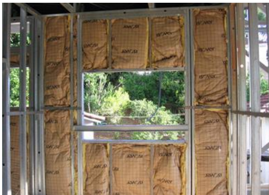
Figura 7 – Mantas de lã de vidro no interior dos painéis para melhoria do desempenho térmico e acústico
