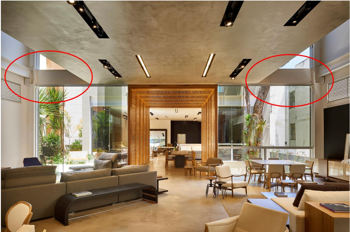
Figura 5.16: Diferença de altura de vigas.
