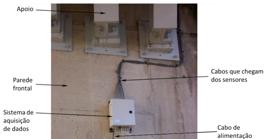
Figura 59 - Vista do sistema de aquisição de dados e dos cabos. Fonte: Cury (2010)
