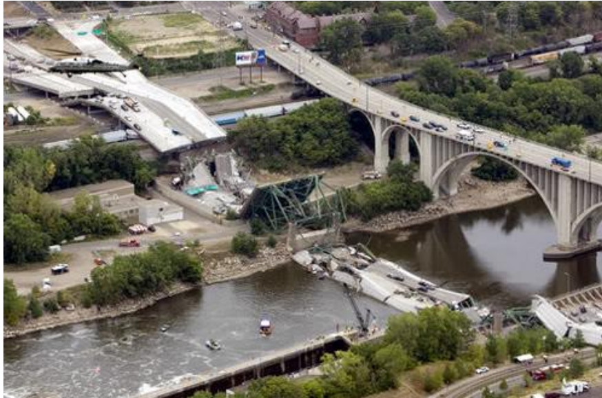
Figura 1.3 – Colapso da ponte I – 35 W sobre o rio Mississippi.
