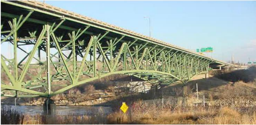
Figura 1.1 – Ponte I-35 W antes do colapso. Fonte: Branco, 2013.
