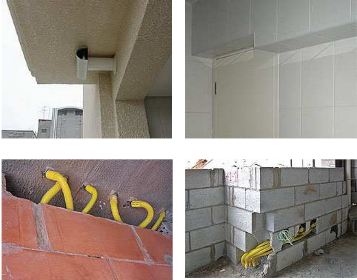
Figura 2.10- Problemas de compatibilização Fonte: LOTURCO, 2008
