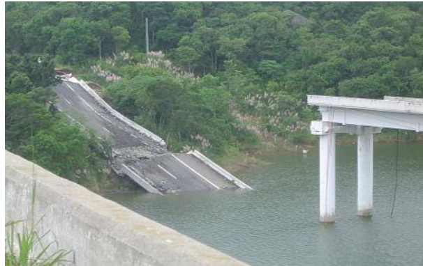
Figura 3. Trecho que desabou na ponte sobre o a Represa do Rio Capivari – Cachoeira em Curitiba.
