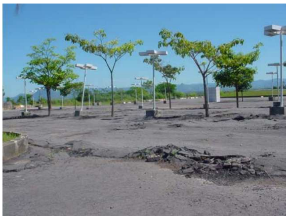
Figura 5 – Exemplo do uso inadequado de escória de aciaria – fissuração longitudinal irregular em pátio de estacionamento. Fonte: Mendonça, 2006.
