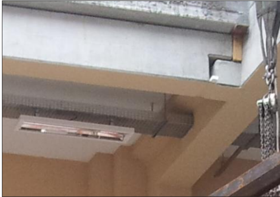
Figura 5.21: Detalhe da eletrocalha passando pela viga Fonte: CSA Arquitetura, 2013
