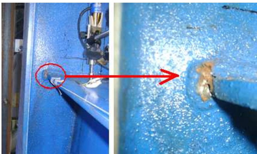
Figura 4.54 – Rompimento da solda no protótipo MIE6a
