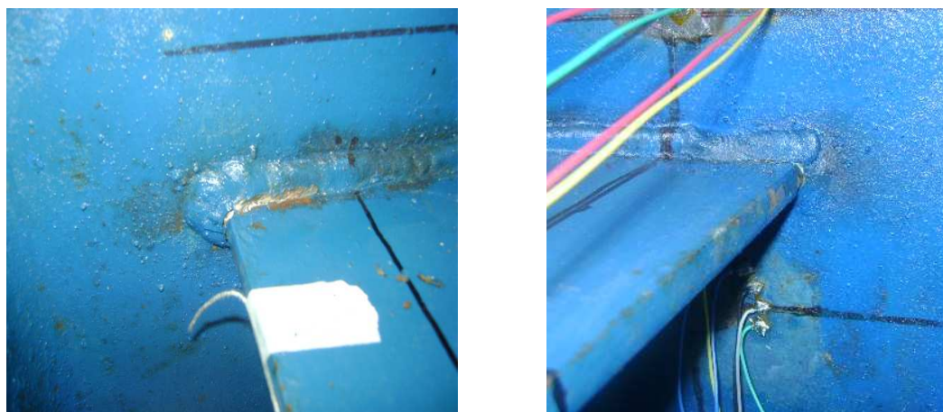
Figura 4.82– Rompimento da solda no protótipo MIE2a
