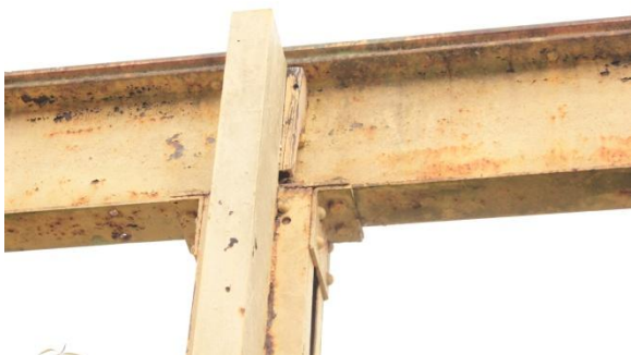
Figura 3. 111: Pontos de corrosão na viga de suporte da ponte rolante – Fundição Ferro e Bronze.
