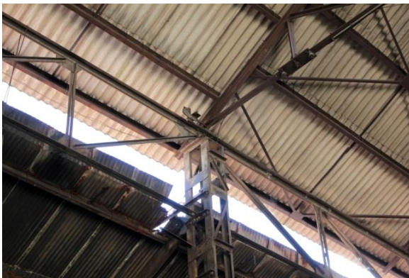
Figura 2. 58: Ligação tesoura, viga e pilar mais nova.
