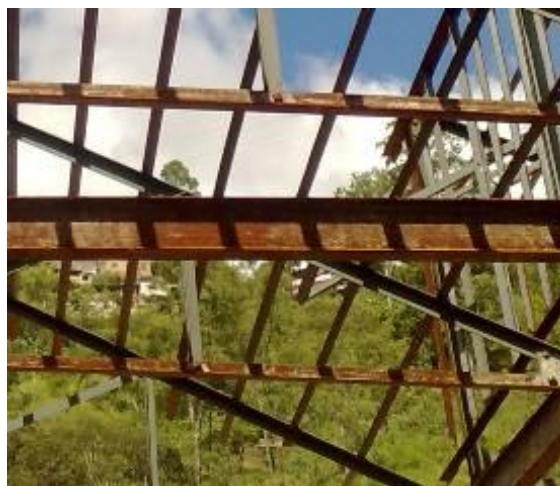
Figura 4. 50: Viga em perfil I laminado em processo de corrosão uniforme. Fonte: Acervo pessoal (07/02/2011)
