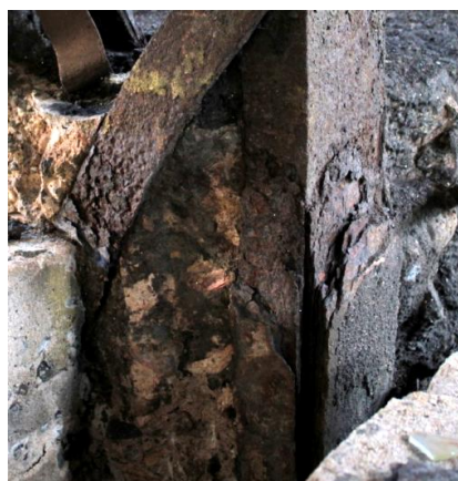
Figura 2. 103: Detalhe da base do Pilar 04 em processo de corrosão – Vão Ponte Rolante. Fonte: Arquivo Pessoal (15/06/12)
