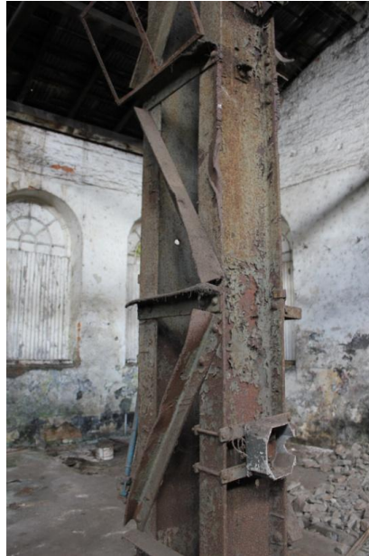
Figura 2. 127: Registro de cantoneiras deformadas no Pilar 20 da Antiga Oficina Mecânica. Fonte: Arquivo Pessoal (15/06/12)
