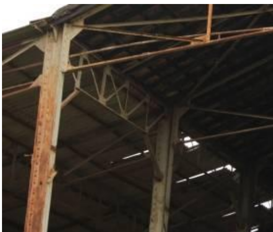
Figura 3. 115: Pilar esquerdo da fachada posterior com corrosão uniforme - Fundição Ferro e Bronze.
