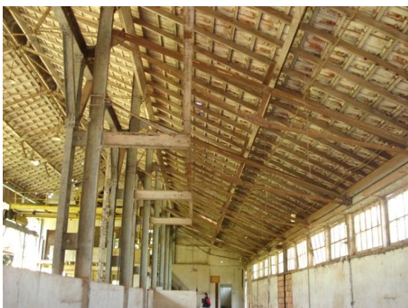
Figura 3. 172: Vista interna do volume lateral - Elétrica
