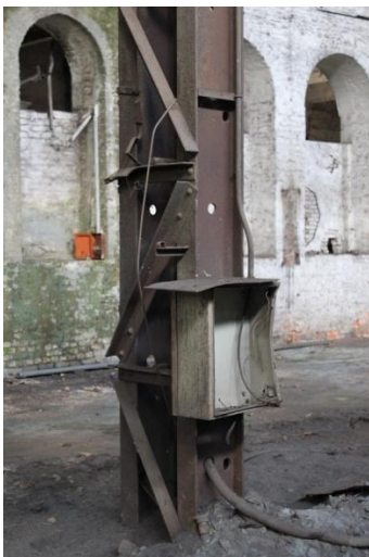
Figura 2. 128: Furos na alma do Pilar 06 da Antiga Oficina Mecânica. Fonte: Arquivo Pessoal (15/06/12)
