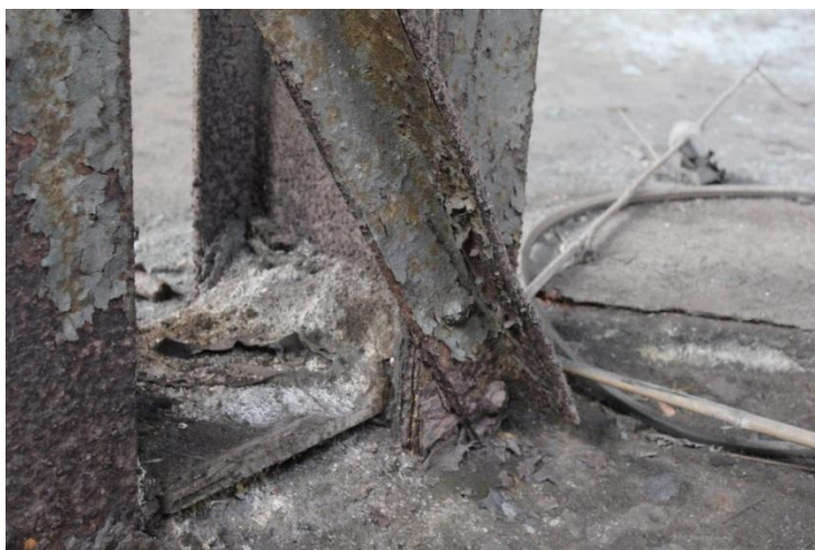
Figura 2. 111: Base do pilar 20 da Oficina em processo de corrosão. Fonte: Arquivo Pessoal (15/06/12)
