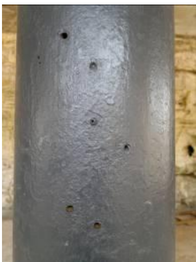
Figura 4. 62: Corrosão em ponto da superfície. Fonte: Acervo pessoal (14/08/2012)
