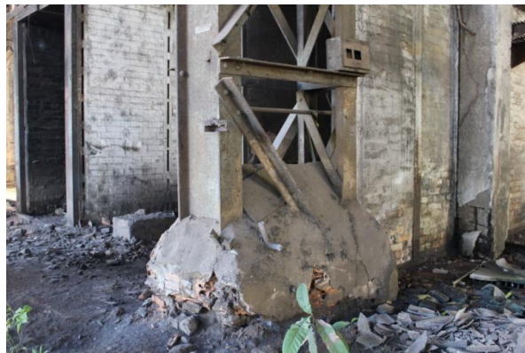
Figura 2. 108: Pilar 02 – Vão Ponte Rolante. Fonte: Arquivo Pessoal (15/06/12)
