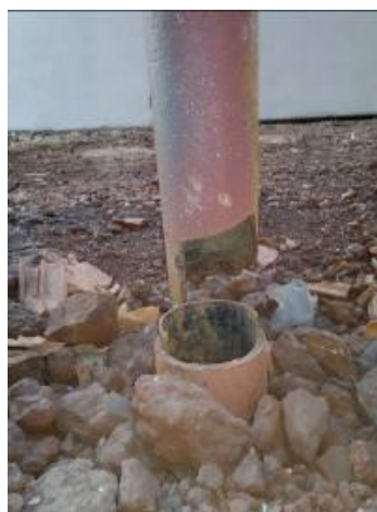
Figura 4. 54: Fratura em base de um pilar do pav. superior.
