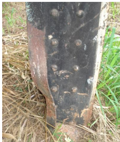
Figura 3. 161: Deformação na chapa da mesa do pilar Galpão B - Almojarifado e Antiga Fábrica de Cadinhos.
