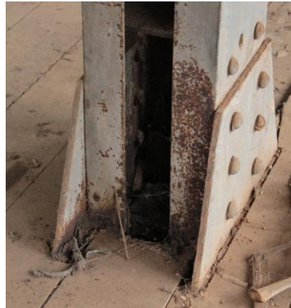
Figura 3. 213: Base de pilar apresenta início de processo de corrosão. Fonte: Arquivo Pessoal – (15/06/12)
