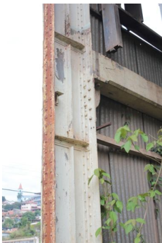
Figura 3. 73: Corrosão uniforme na mesa do Pilar 02 - Galpão A1 da Oficina Mecânica. Fonte: Arquivo Pessoal – (15/06/12)
