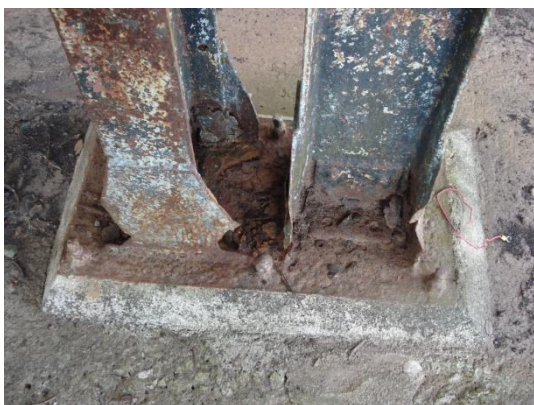
Figura 3. 132: Corrosão avançada na base do pilar do Galpão secundário, Boca da Mina. Fonte: Arquivo Pessoal – (21/10/11)
