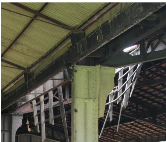
Figura 3. 152: Topo do pilar de divisa entre galpões - Almojarifado e Fábrica de cadinhos. Fonte: Arquivo Pessoal – (15/06/12)
