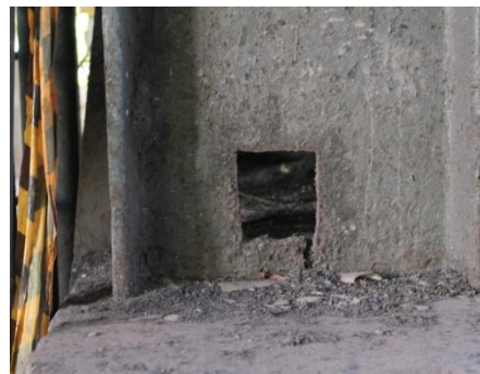
Figura 2. 129: Recorte na alma do Pilar 03 do vão da ponte da rolante. Fonte: Arquivo Pessoal (15/06/12)
