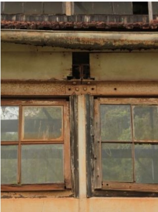
Figura 3. 183: Estrutura da Fachada lateral direita apresenta corrosão uniforme - Galpão da Elétrica
