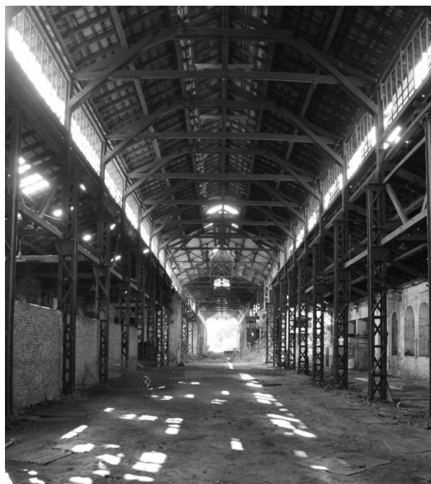
Figura 2. 66: Vista interna do galpão a partir da Oficina Mecânica. Fonte: Arquivo Pessoal – (15/06/12)
