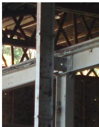
Figura 3. 129: Ligação pilar metálico e estrutura ponte rolante - Galpão secundário - Boca da Mina.
