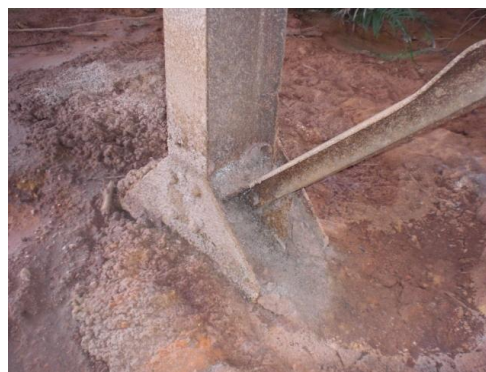
Figura 3. 82: Base do pilar em contato com o solo – Galpão B Oficina Mecânica Fonte: Arquivo Pessoal – (março 2011)
