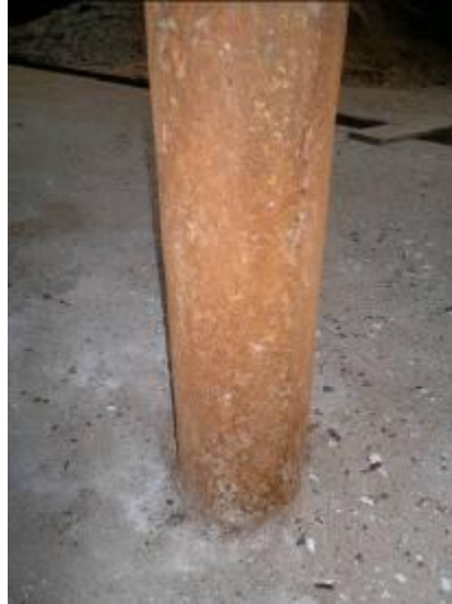
Figura 4. 65: Base da coluna em corrosão uniforme.
