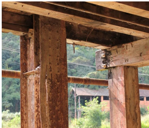
Figura 3. 165: Pilar apresenta fratura - pavimento inferior do Almojarifado e Fábrica de cadinhos.
