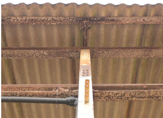
Figura 3. 88: Processo de corrosão uniforme na estrutura do Galpão D da Oficina Mecânica e Ferraria
