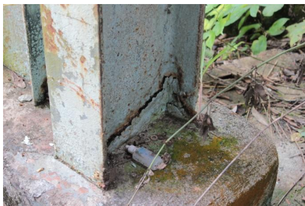
Figura 3. 133: Processo de corrosão na base do pilar - Galpão secundário, Boca da Mina Fonte: Arquivo Pessoal – (21/10/11)
