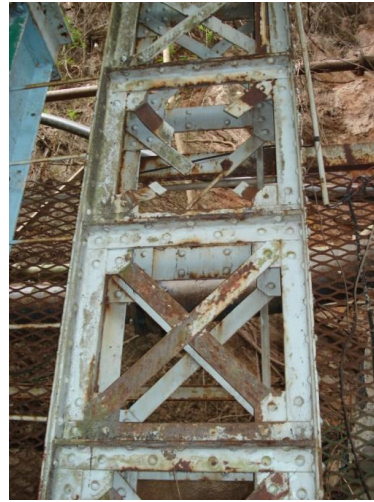
Figura 3. 141: Pilar 01 apresenta ruptura de chapa - Galpão principal, Boca da Mina Fonte: Arquivo Pessoal – (15/06/12)
