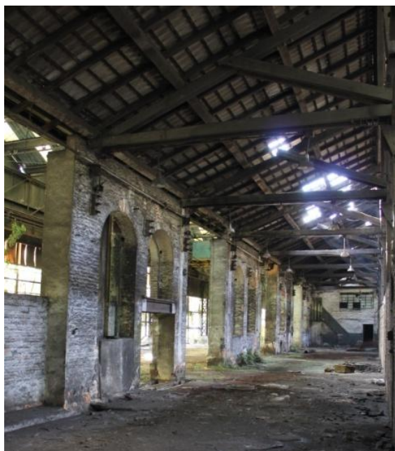
Figura 2. 74: Vista interna lateral direita Oficina Mecânica Fonte: Arquivo Pessoal – (15/06/12)
