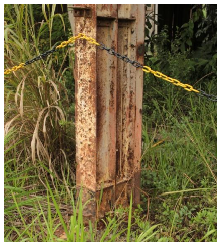
Figura 3. 74: Base do Pilar 04 apresenta processo de corrosão – Galpão A1 da Oficina Mecânica. Fonte: Arquivo Pessoal – (15/06/12)
