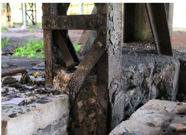
Figura 2. 102: Base do Pilar 04 em processo de corrosão avançado – Vão Ponte Rolante. Fonte: Arquivo Pessoal (15/06/12)
