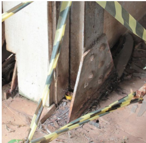
Figura 3. 214: Corrosão na base do pilar de extremidade do eixo central - Modelagem Fonte: Arquivo Pessoal – (15/06/12)
