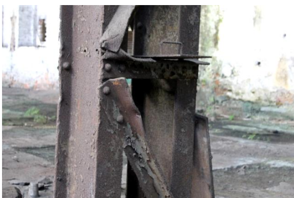
Figura 2. 124: Cantoneiras deformadas no Pilar 14 – Antiga Oficina Mecânica.
