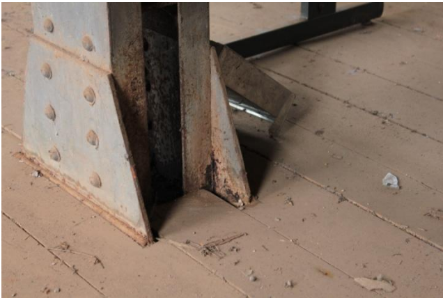
Figura 3. 212: Corrosão uniforme e em frestas. Fonte: Arquivo Pessoal – (15/06/12)
