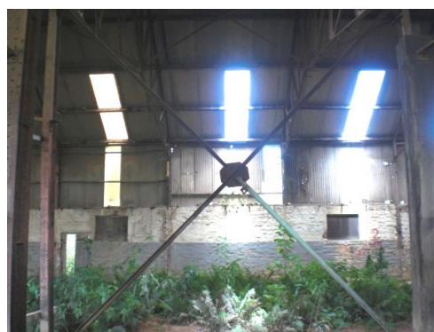
Figura 3. 84: Contraventamento do Galpão B da Oficina Mecânica Fonte: Arquivo Pessoal – (março 2011)
