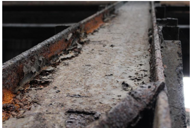
Figura 2. 113: Processo corrosão de corrosão mais avançado no pilar 11 da Oficina Mecânica.
