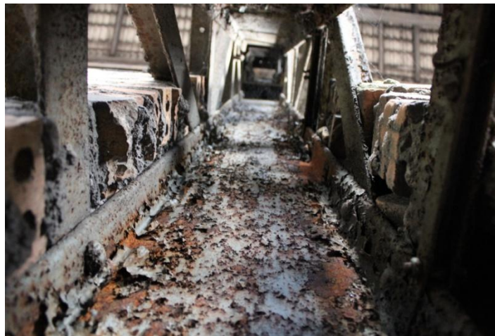
Figura 2. 117: Processo de corrosão do pilar 15 da Oficina. Fonte: Arquivo Pessoal (15/06/12)
