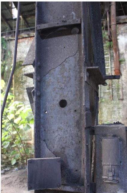
Figura 2. 100: Início de processo de corrosão uniforme – Pilar 02 – Oficina Mecânica. Fonte: Arquivo Pessoal (15/06/12)
