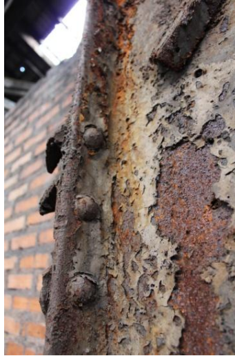
Figura 2. 115: Processo de corrosão do pilar 11 – Oficina Fonte: Arquivo Pessoal (15/06/12)
