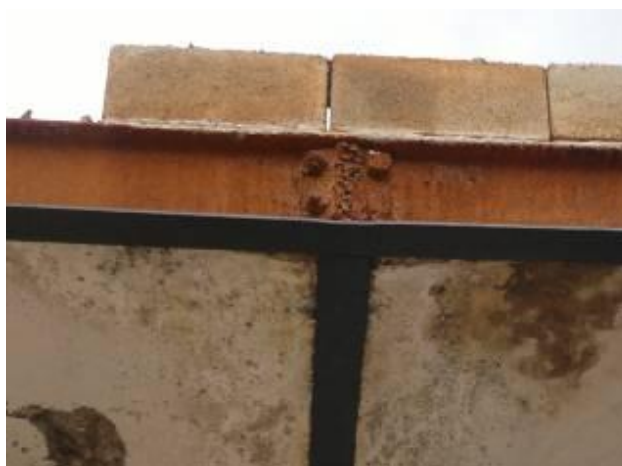
Figura 4. 63: Corrosão uniforme na viga de borda, mais acentuada na região dos conectores. Fonte: Acervo pessoal (14/08/2012)
