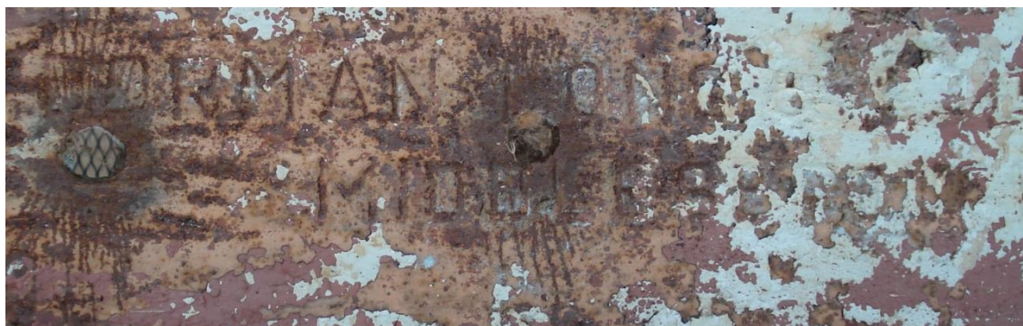
Figura 3. 144: Inscrição em Pilar - Galpão secundário, Boca da Mina Fonte: Arquivo Pessoal – (21/10/11)
