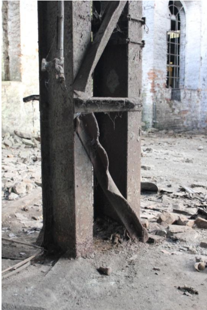
Figura 2. 126: Cantoneiras deformadas no Pilar 20 da Antiga Oficina Mecânica. Fonte: Arquivo Pessoal (15/06/12)
