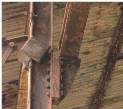
Figura 3. 89: Corrosão uniforme na estrutura do Galpão D da Oficina Mecânica e Ferraria.
