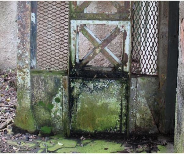
Figura 3. 140: Alvenaria inserida na base do Pilar 01 proporciona acúmulo de umidade e sujidade - Galpão principal da Boca da Mina Fonte: Arquivo Pessoal – (15/06/12)
