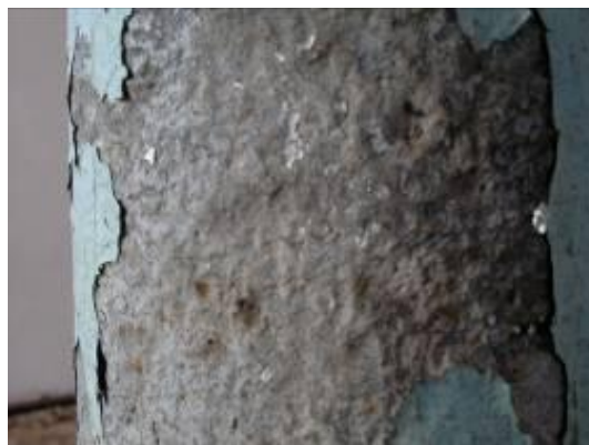
Figura 4. 52: Pilar em ferro fundido do pavimento superior apresenta pontos de corrosão em sua superfície. Fonte: Acervo pessoal (25/07/2012)
