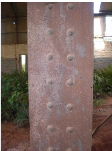
Figura 3. 71: Corrosão uniforme – pilar 03 Galpão A1 Oficina Mecânica. Fonte: Arquivo Pessoal – (março 2011)
