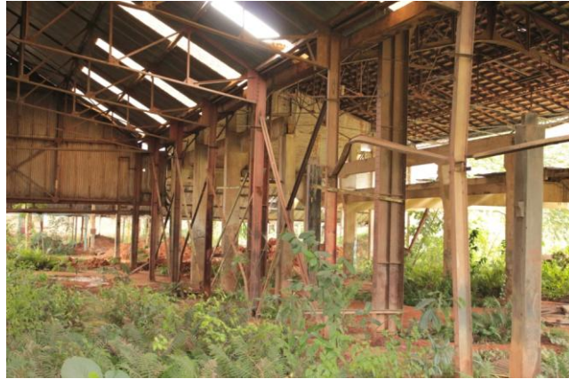
Figura 3. 85: Problemas de estabilidade estrutural – Galpão B Oficina Mecânica Fonte: Arquivo Pessoal – (15/06/12)
