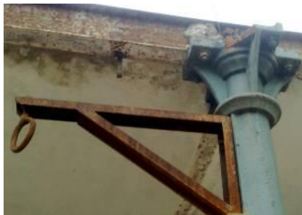
Figura 4. 57: Junção viga de borda e coluna do subsolo. Fonte: Acervo pessoal (07/02/2011)
