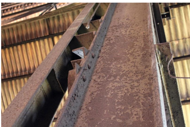
Figura 2. 98: Processo de corrosão uniforme – Pilar 01 – Vão Ponte Rolante.
