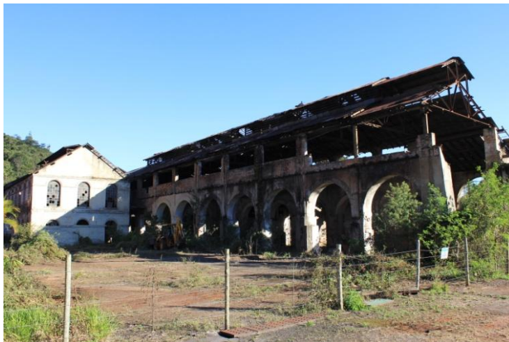
Figura 2. 44: Fachada lateral esquerda – antiga Fundição e prédio da Modelagem. Fonte: Arquivo Pessoal – (15/06/12)
