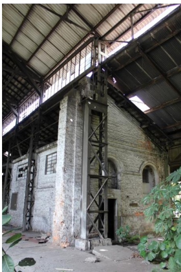
Figura 2. 61: Pilar 07 – Vão ponte rolante Fonte: Arquivo Pessoal – (15/06/12)
