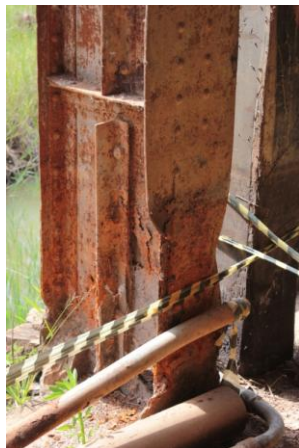
Figura 3. 164: Pilar em processo de corrosão no pavimento inferior do Almojarifado e Fábrica de cadinhos.
