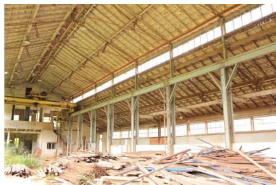
Figura 5.17: Foto interna Elétrica - Morro Velho Fonte: Acervo Pessoal (22/06/12)
