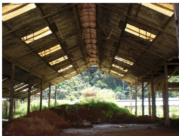
Figura 5. 21: Estrutura híbrida em madeira e metal no Galpão C da Mecânica - Morro Velho Fonte: Acervo Pessoal (março, 2011)
