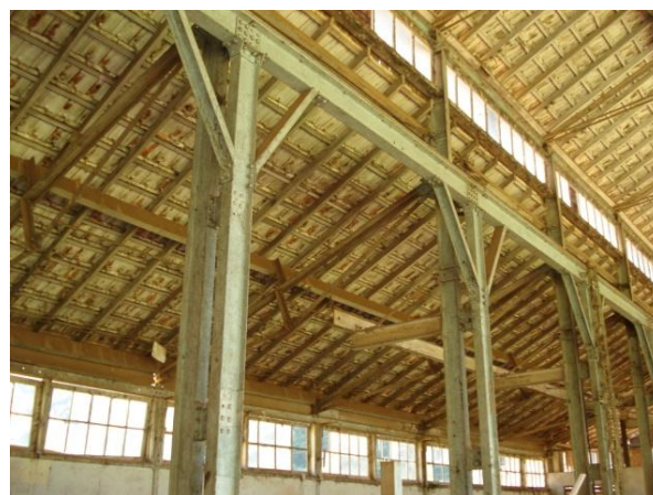
Figura 3. 173: Vista interna da estrutura - Elétrica
