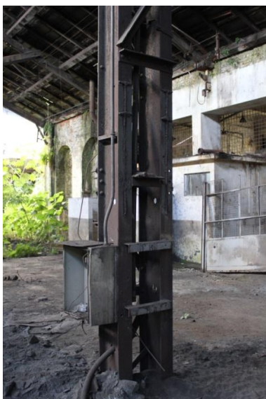
Figura 2. 122: Pilar 06 da Antiga Oficina Mecânica apresenta ausência de cinco cantoneiras.
