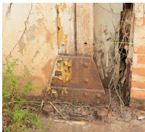
Figura 3. 118: Corrosão em chapa de base do pilar de suporte da ponte rolante da fachada posterior – Fundição Ferro e Bronze.
