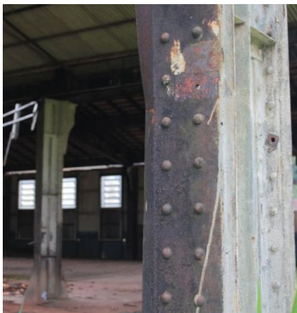
Figura 3. 160: Deformação na mesa do pilar Galpão B - Almojarifado e Antiga Fábrica de Cadinhos.
