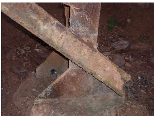
Figura 3. 81: Processo de corrosão na base do pilar – Galpão B Oficina Mecânica Fonte: Arquivo Pessoal – (março 2011)
