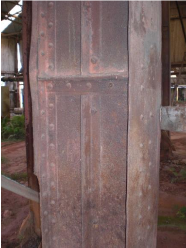
Figura 3. 69: Pilar 03 do Galpão A1 da Oficina Mecânica apresenta fratura na chapa que compõe a mesa. Fonte: Arquivo Pessoal – (março 2011)
