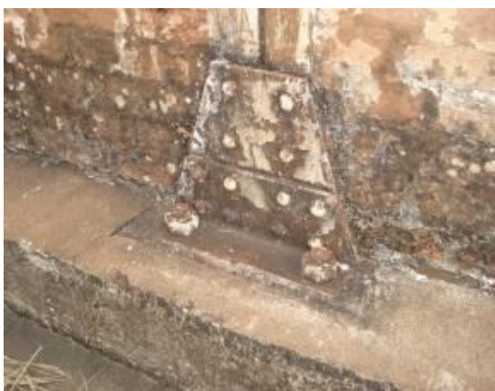
Figura 3. 117: Base pilar da fachada lateral esquerda em bom estado de conservação – Fundição Ferro e Bronze.
