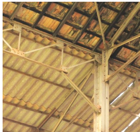
Figura 3. 108: Ligação viga, pilar e tesoura - Fundição Ferro e Bronze. Fonte: Arquivo Pessoal – (15/06/12)
