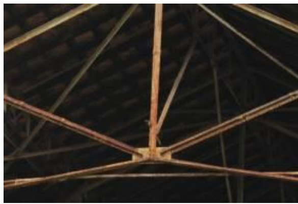
Figura 3. 114: Corrosão uniforme em cantoneiras da tesoura treliçada da fachada posterior – Fundição Ferro e Bronze.
