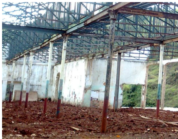
Figura 4. 55: Junção vigas desalinhadas.
