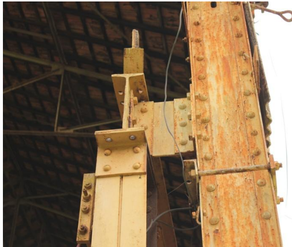
Figura 3. 106: Ligação do pilar e estrutura ponte rolante - Fundição Ferro e Bronze. Fonte: Arquivo Pessoal – (15/06/12)
