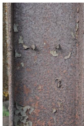
Figura 2. 99: Processo de corrosão uniforme – Pilar 18 – Oficina Mecânica.
