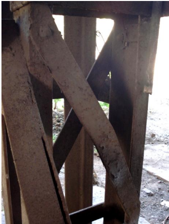
Figura 2. 118: Fratura na cantoneira e deformação na barra de ligação - pilar 01 – vão ponte rolante. Fonte: Arquivo Pessoal (15/06/12)
