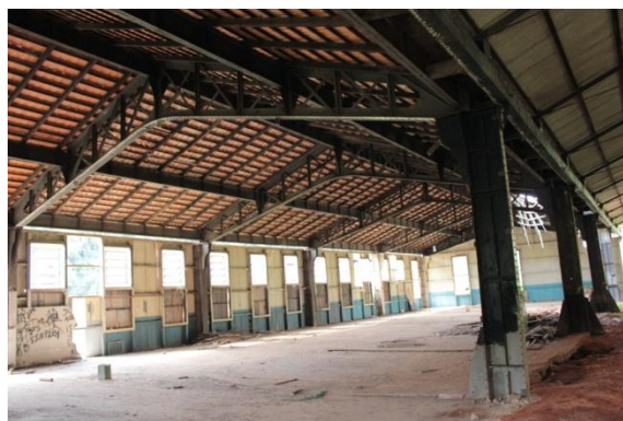
Figura 3. 149: Vista interna da estrutura do Galpão A - Almojarifado e antiga Fábrica de cadinhos.
