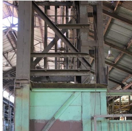
Figura 2. 119: Cortes nas cantoneiras de ligação do pilar 03 - vão ponte rolante. Fonte: Arquivo Pessoal (15/06/12)
