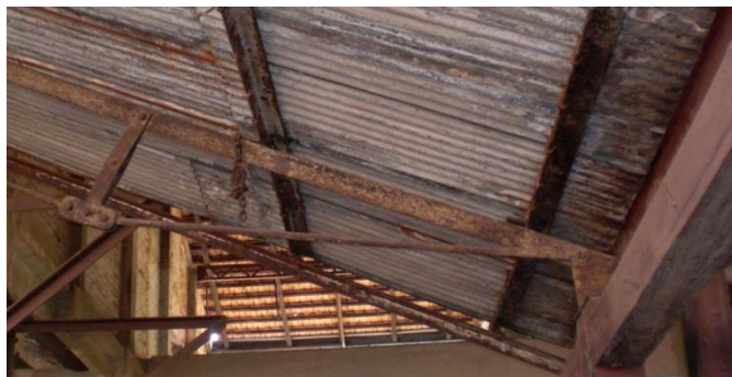
Figura 3. 87: Corrosão uniforme nas tesouras tipo vagão – Galpão C Oficina Mecânica.
