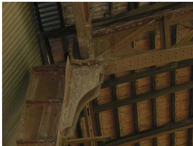
Figura 3. 72: Corrosão uniforme em tesoura e pilar 03 – Galpão A1 Oficina Mecânica. Fonte: Arquivo Pessoal – (março 2011)
