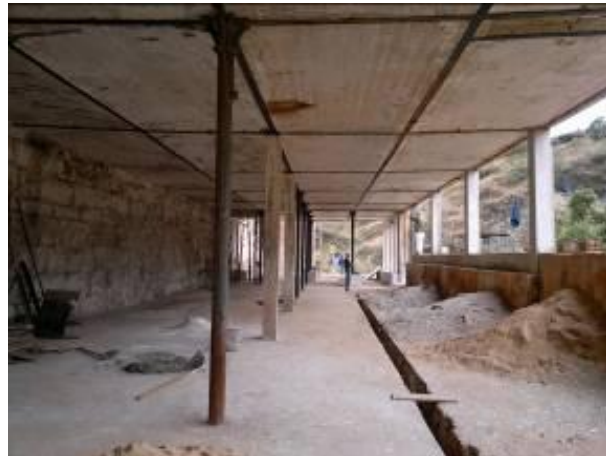
Figura 4. 44: Vista interna do subsolo após as demolições e aberturas. Fonte: Acervo pessoal (14/08/2012)
