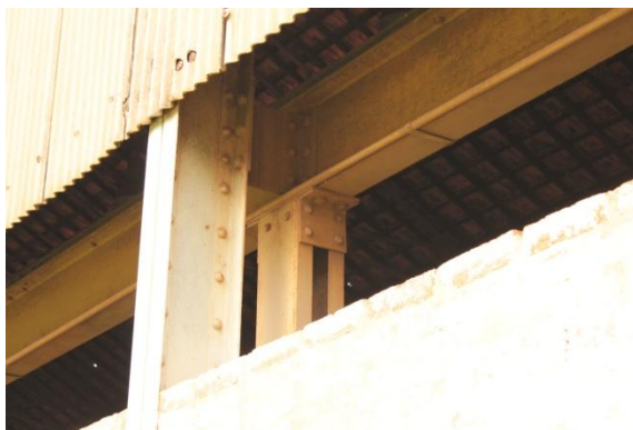
Figura 3. 112: Estrutura interna aparentemente em bom estado de conservação – Fundição Ferro e Bronze.
