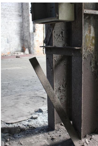
Figura 2. 120: Cantoneira do Pilar 02 encontra-se desprendida – Antiga Oficina Mecânica. Fonte: Arquivo Pessoal (15/06/12)
