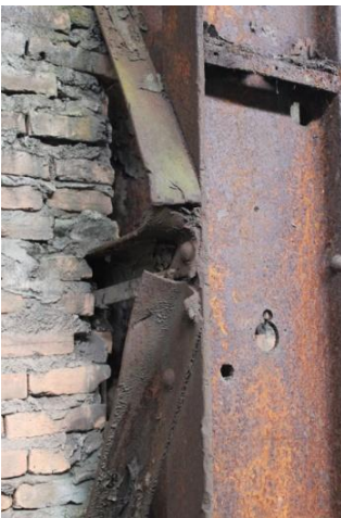
Figura 2. 116: Pilar 13 da Oficina em processo de corrosão e cantoneiras deformadas. Fonte: Arquivo Pessoal (15/06/12)
