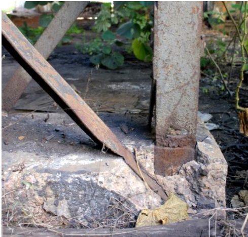
Figura 2. 106: Pilar 06 – Vão Ponte Rolante. Fonte: Arquivo Pessoal (15/06/12)
