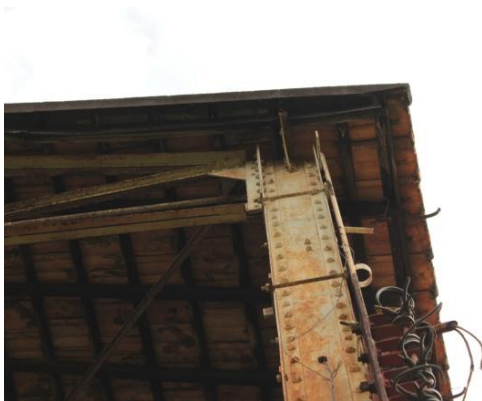
Figura 3. 113: Processo de corrosão uniforme em pilar direito Fachada Posterior – Fundição Ferro e Bronze.
