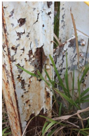
Figura 3. 186: Corrosão uniforme em pilar da fachada lateral esquerda - Elétrica
