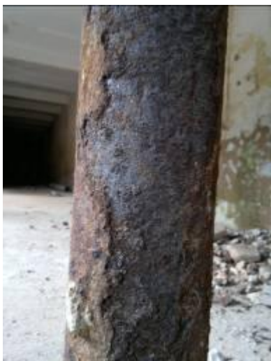
Figura 4. 68: Coluna em processo de corrosão com perda de massa. Fonte: Acervo pessoal (14/08/2012)
