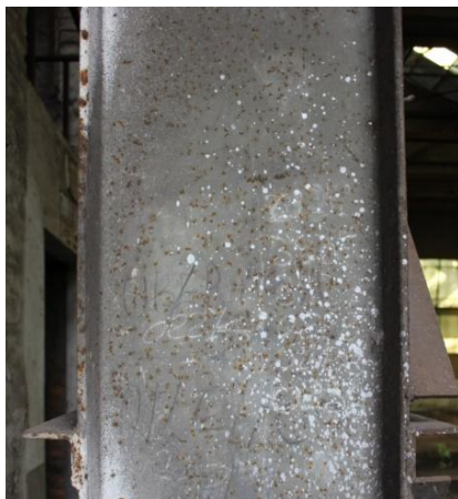
Figura 2. 109: Início de processo de corrosão no Pilar 07 do Vão da Ponte Rolante. Fonte: Arquivo Pessoal (15/06/12)
