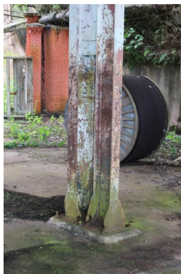
Figura 3. 135: Pilar em processo de corrosão uniforme, de forma mais acentuada na base - Galpão secundário, Boca da Mina Fonte: Arquivo Pessoal – (21/10/11)
