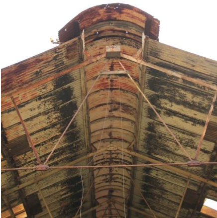
Figura 3. 86: Aspecto de corrosão na tesoura e telhas de cobertura - Galpão C Oficina Mecânica.
