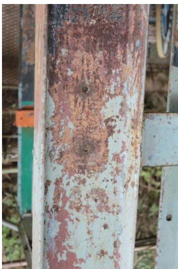
Figura 3. 134: Corrosão uniforme em pilar do Galpão secundário, Boca da Mina Fonte: Arquivo Pessoal – (21/10/11)
