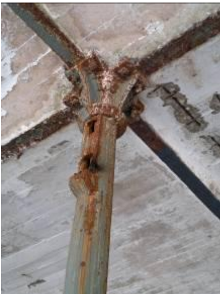
Figura 4. 66: Capitel da coluna em processo de corrosão mais acentuado em frestas, bordas e conectores.
