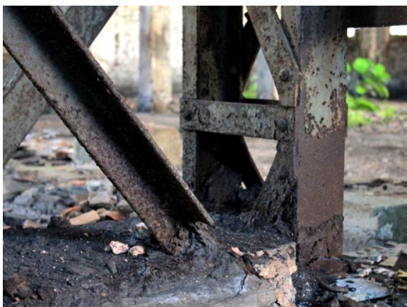
Figura 2. 104: Cantoneira do Pilar 04 em processo de corrosão – Vão Ponte Rolante. Fonte: Arquivo Pessoal (15/06/12)
