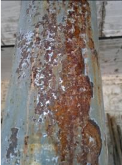
Figura 4. 64: Coluna em processo de corrosão generalizada.
