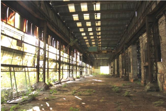
Figura 2. 90: Vista interna do galpão metálico com cobertura em shed na lateral da Oficina. Fonte: Arquivo Pessoal – (15/06/12)
