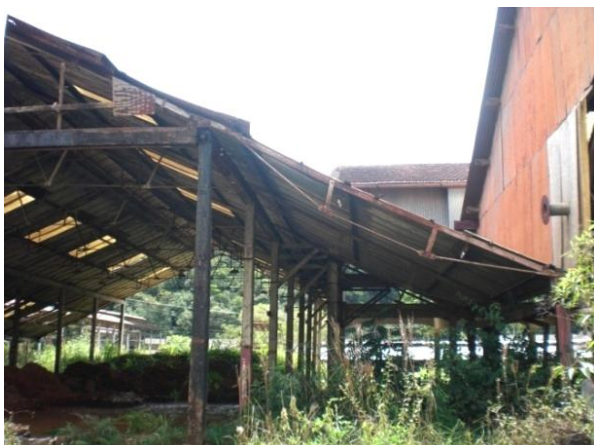
Figura 3. 57: Vista lateral galpão C – Oficina Mecânica e Ferraria. Fonte: Arquivo Pessoal – (março/11)
