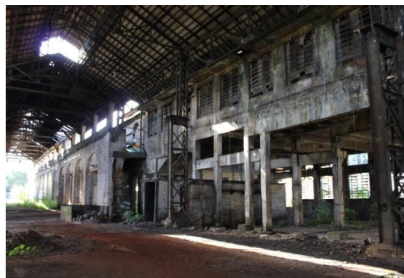
Figura 2. 84: Vista do galpo E, em concreto, a partir do vo da ponte rolante. Fonte: Arquivo Pessoal – (15/06/12)
