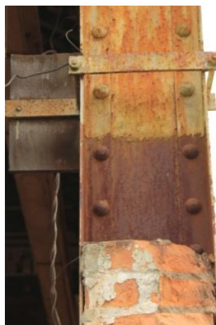
Figura 3. 116: Pilar preenchido com tijolos possibilita acúmulo de umidade e processo de corrosão mais acentuada - Fundição Ferro e Bronze.
