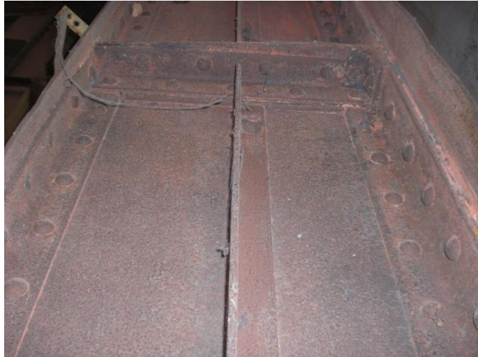
Figura 3. 70: Corrosão uniforme no Pilar 03 – Galpão A1 Oficina Mecânica. Fonte: Arquivo Pessoal – (março 2011)
