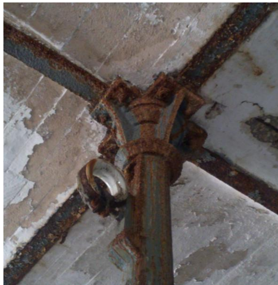
Figura 4. 67: Capitel da coluna em processo de corrosão em 2011.
