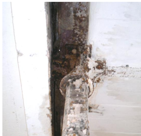
Figura 4. 69: Capitel em processo de corrosão em frestas, por tensão e/ou por processo galvânico. Fonte: Acervo pessoal (14/08/2012)
