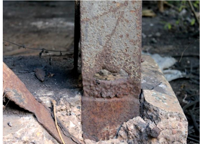
Figura 2. 107: Pilar 06 – Vão Ponte Rolante. Fonte: Arquivo Pessoal (15/06/12)
