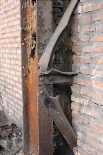
Figura 2. 114: Cantoneiras do pilar 11 apresentam deformação e fraturas. Fonte: Arquivo Pessoal (15/06/12)
