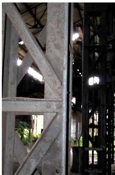
Figura 2. 123: Pilar 08 da Oficina Mecânica recebeu corte em cantoneira para passagem de tubulação.
