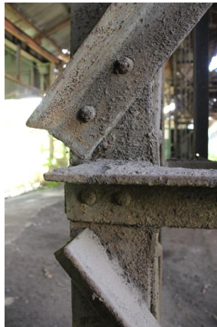
Figura 2. 101: Início de processo de corrosão uniforme – Pilar 05 – Vão ponte rolante. Fonte: Arquivo Pessoal (15/06/12)
