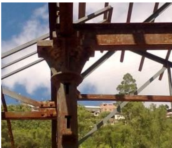
Figura 4. 49: Processo de corrosão uniforme na viga laminada e na coluna em ferro fundido. Fonte: Acervo pessoal (07/02/2011)
