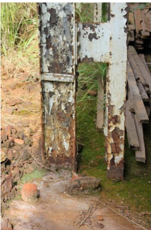
Figura 3. 185: Base do pilar apresentando material de corrosão - Elétrica
