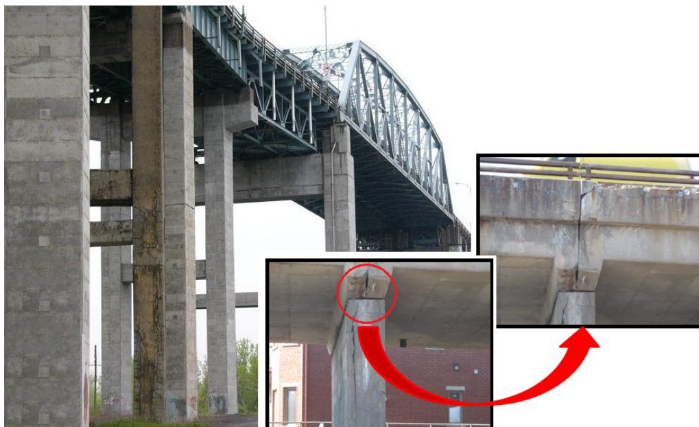
FIGURA 2.1 – Ponte Honoré-Mercier em Montreal e detalhes das fissuras em um de seus pilares. FONTE – CURY, 2010.
