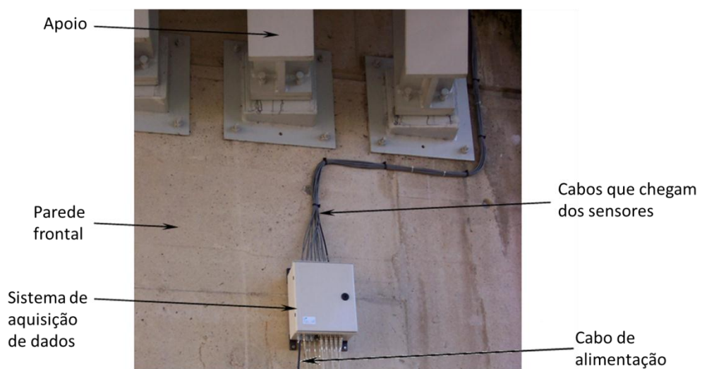
FIGURA 6.4 – Vista do sistema de aquisição de dados e dos cabos. FONTE – CURY, 2010.
