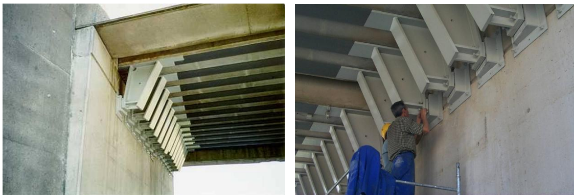
FIGURA 6.6 b, c – Detalhe dos mancais e procedimento de reforço. FONTE – CURY, 2010.
