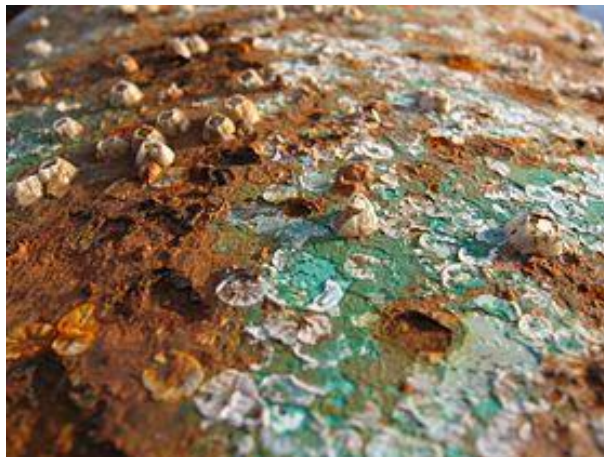
Figura 3. 7 - Corrosão galvânica [ http://www.electraservice.com.br/noticias.asp . Acessado em 10/07/2009].
