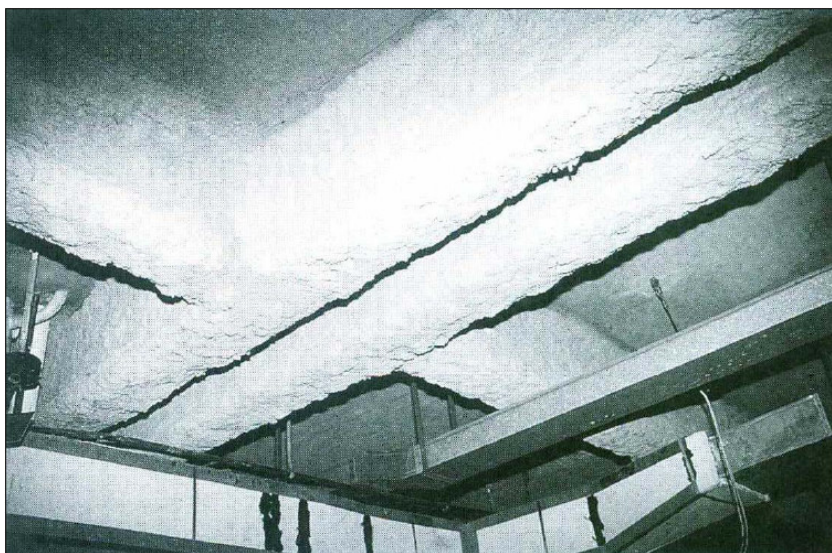
Figura 3-10. Vigas de aço revestidas com argamassa de vermiculita, por meio de spray.
