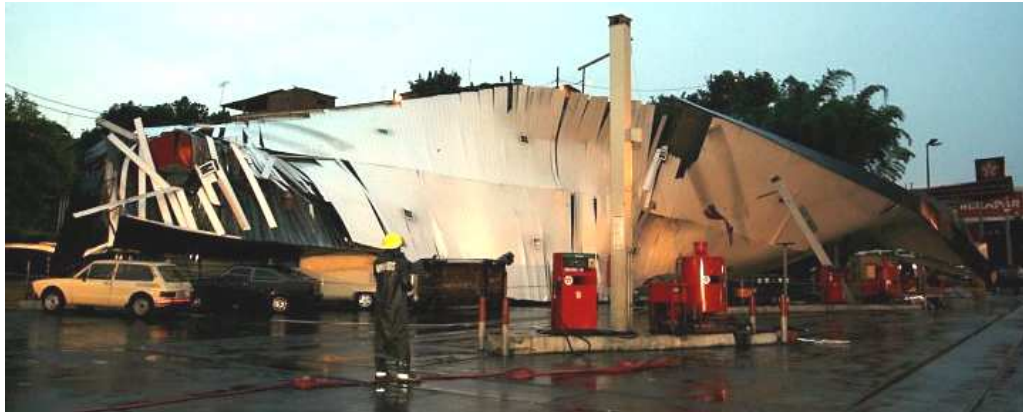
Figura 2.1 - Posto de combustível em Contagem - MG destruído pela ação do vento (Fonte: www.globo.com.br - 2007).
