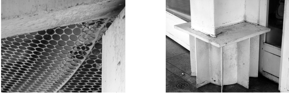
Figura 6.22. Tela de proteção contra pombos no desvão do forro (e) e pontos de corrosão estrutural.
