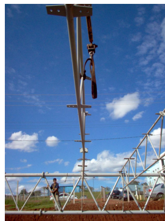
(b) Detalhe da terça sem o travamento durante a montagem na primeira etapa.
