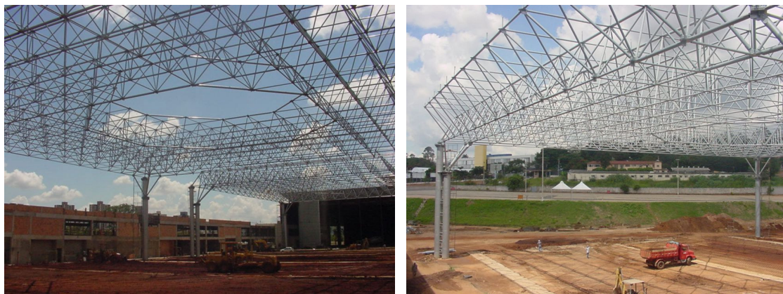
Figura 2.44: Aplicações da treliça espacial. Centro de Eventos Expominas, em Belo Horizonte, MG. Fonte: Arquivo pessoal, 2004.
