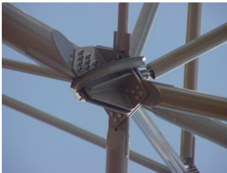
Figura 5.2: Nó de treliça espacial. Detalhe da cobertura do Centro de Eventos Expominas, em Belo Horizonte, MG. Fonte: Arquivo pessoal, 2004.
