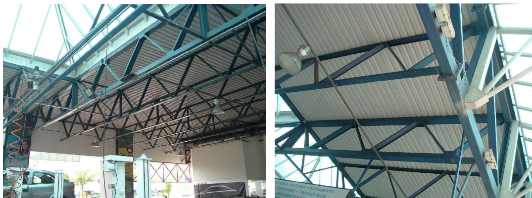
Figura 2.45: Estrutura de cobertura em viga treliçada plana pré-fabricada. Concessionária de veículos em Belo Horizonte, MG. Fonte: Arquivo pessoal, 2005.
