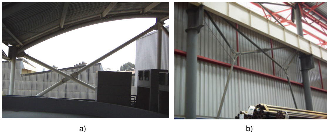
Figura 2.36: Contraventamento em a) “X” e b) “Y”, executados com perfis tubulares no galpão da Açotubo em Guarulhos, São Paulo. Fonte: Arquivo pessoal, 2005.
