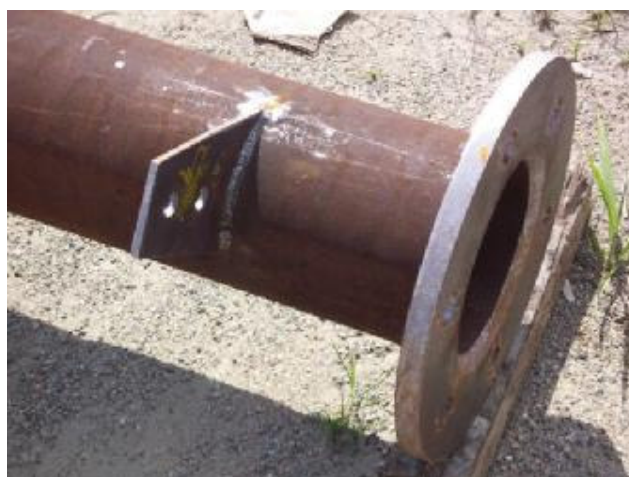
Figura 5.26: Chapa circular de ligação entre os banzos da viga principal (ligação flangeada) e chapa de ligação da diagonal da terça. Montagem da estrutura na empresa Brafer. Fonte: Arquivo pessoal, 2005.
