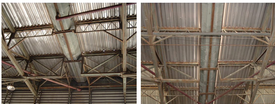
Figura 2.47: Estado de conservação da cobertura em treliça, realizada com cantoneiras e perfis tipo caixaõ. Mercado Distrital, Belo Horizonte. Fonte: Arquivo Pessoal, 2005.
