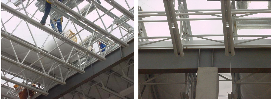
Figura 3.13: “Joists” em treliça, com apoios na viga principal. Sistema de Cobertura do Hipermercado EXTRA, Belo Horizonte, MG. Fonte: Arquivo pessoal, 2004.
