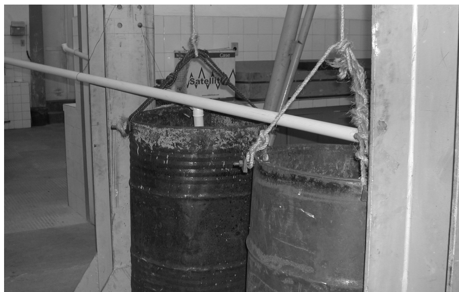
Figura 5.21. Sistema de tubos para adição de água.
