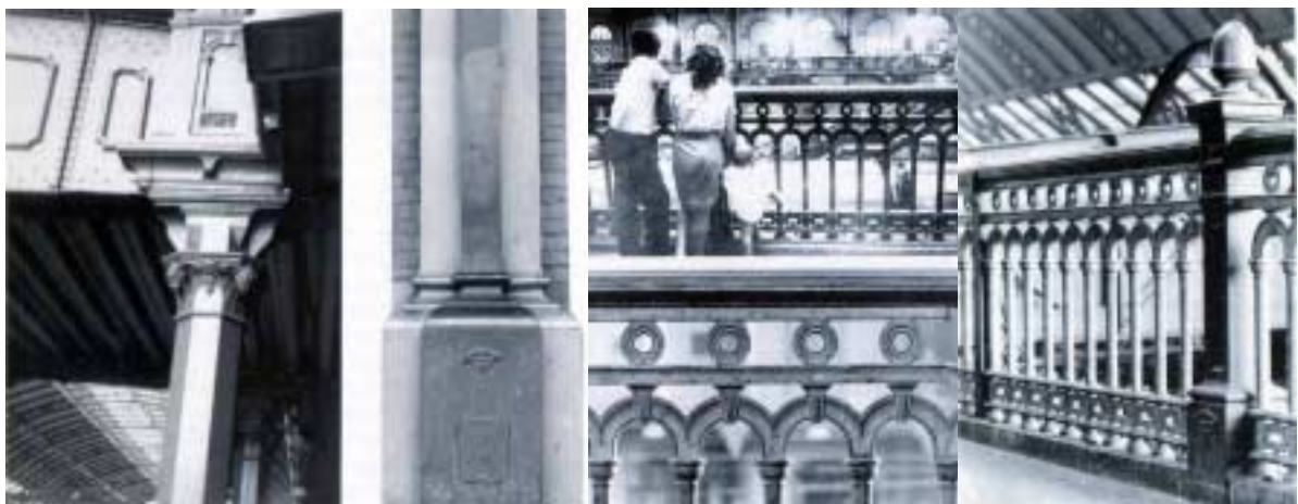
FIGURA 1.6 – Pilares e grades em ferro fundido de MacFarlane & Co na Estação da Luz em São Paulo FONTE - COSTA, 2001.p.114-115.
