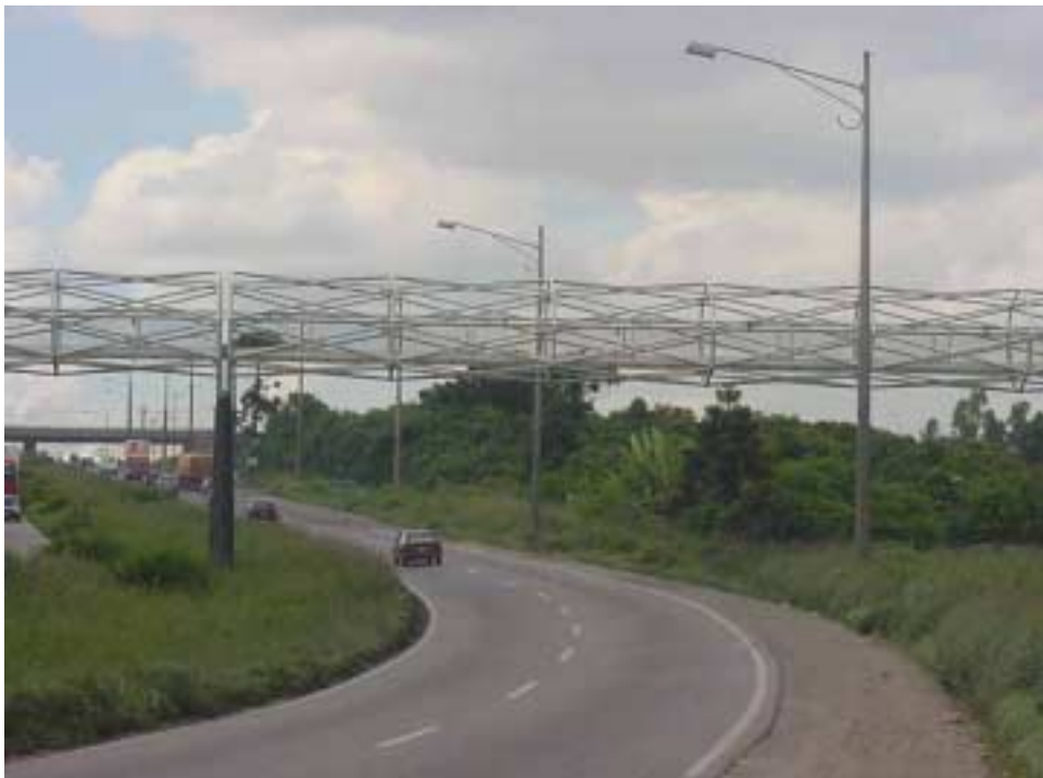
FIGURA 7.31 – Passarela em Curitiba de estrutura tubular reticulada hiperbólica FONTE - Foto gentilmente cedida por Fernanda de Sousa Gerken.
