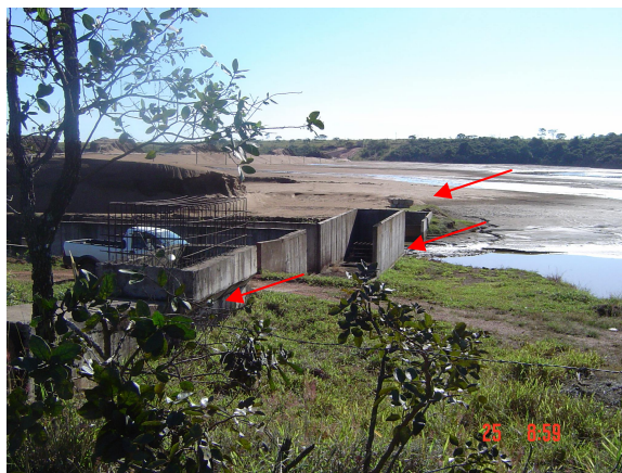
Figura 2.16 – Sistema extravasor de cheias. Detalhe dos emboques em cotas variáveis. (Barragem B5 - Bunge Fertilizantes S/A)
